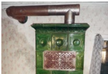
Rechts: Rohrleitungen lückenhaft gedämmt
